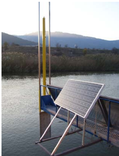
Σχήμα 5. Ηλιακό πάνελ για την εξασφάλιση ενέργειας λειτουργίας συστήματος
