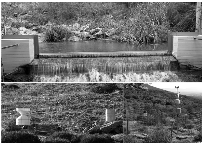
Σχήμα 4. Υπερχειλιστής εγκατεστημένος στην έξοδο της πειραματικής λεκάνης, βροχογράφος, βροχόμετρο και μετεωρολογικός σταθμός.
