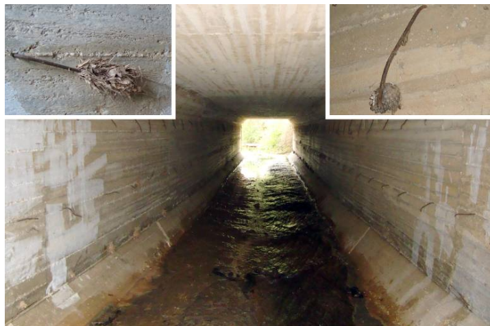
Σχήμα 2. Σημάδια μέγιστου βάθους ροής στον πλακοσκεπή αγωγό ορθογωνικής διατομής Της πειραματικής υδρολογικής λεκάνης.
